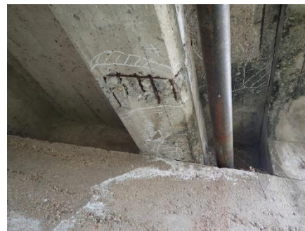
図 1.4 コンクリート橋の損傷
