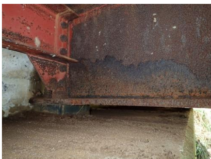
図 1.3 鋼橋の損傷状況
