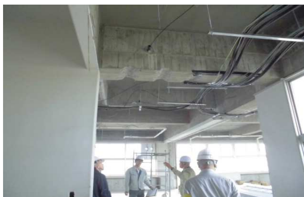
RC梁底部分の欠損
