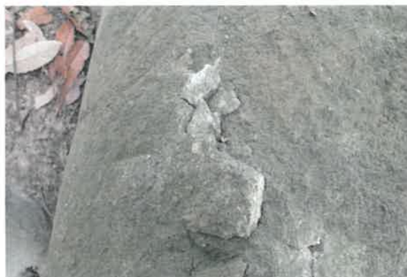
写真90 赤山古墳 1号石棺（棺蓋）の劣化状況
