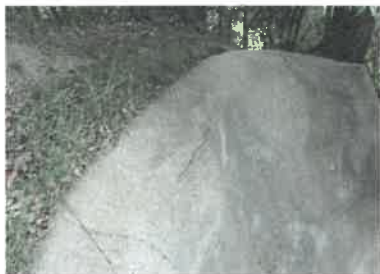
写真106 赤山古墳の擁壁の亀裂
