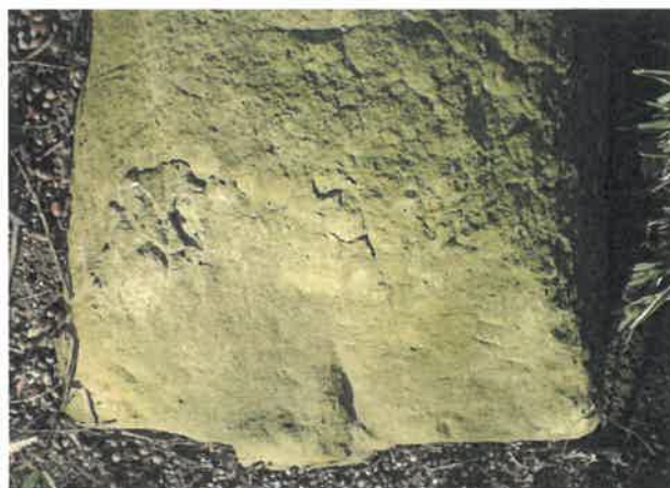
写真89 赤山古墳2号石棺（棺蓋）の劣化状況
