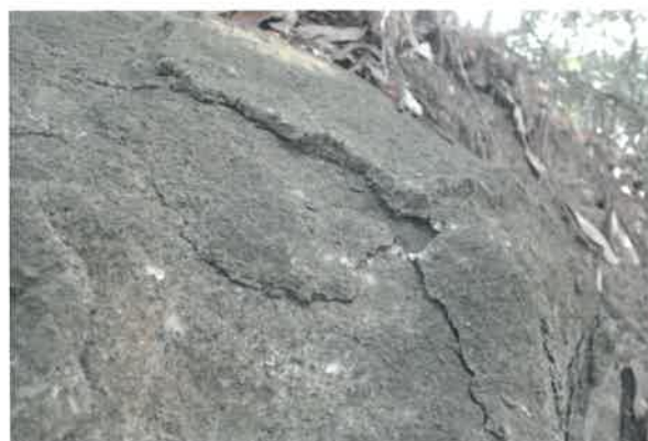
写真91 赤山古墳 1号石棺（棺蓋）の劣化状況
